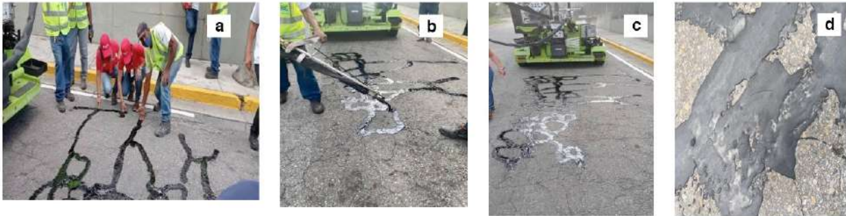
Figura 3. Prueba experimental de producto tecnológico ASFEL™ (a,b y c) y el producto comercial NUVO Elite D como materiales para el sellado de grietas de pavimentos
